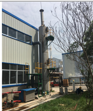
水喷淋+排气筒
