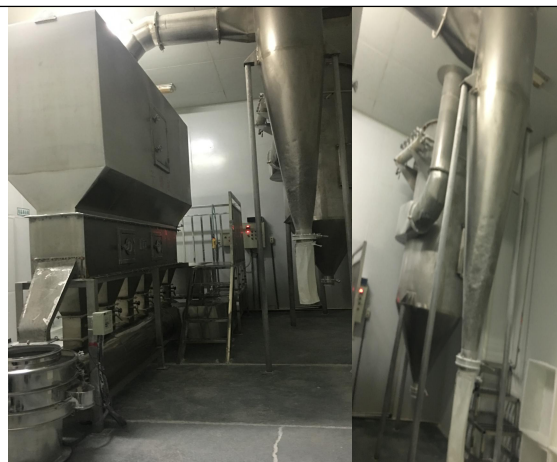
旋风除尘器+袋式除尘器
